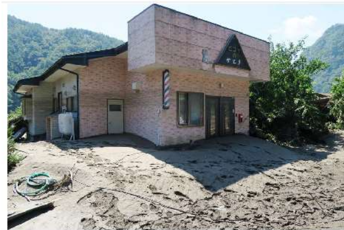
写真4 土砂の堆積状況
