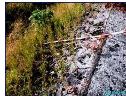
堤防の劣化状況
